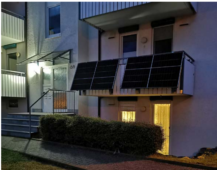
In zahlreichen Größen und Varianten erhältlich: Eine Mini-PV-Anlage hier als sogenanntes „Balkonkraftwerk“ genutzt.
